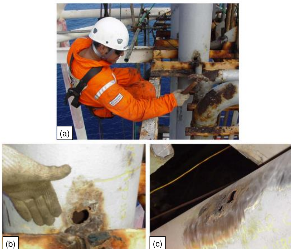
Figura 3 - Danos por corrosão em tubulação Fonte: Costa-Mattos et al. (2009)
