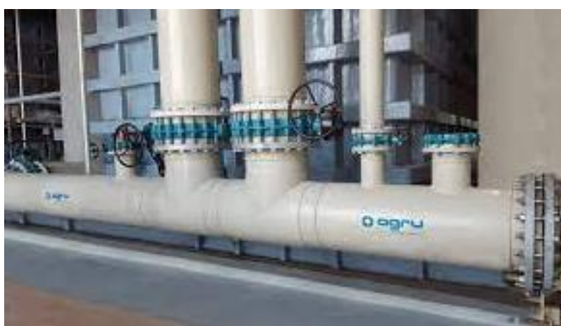
Figura 1 - Tubulação industrial com acessórios e derivações Fonte: Portal Agru (2022)
