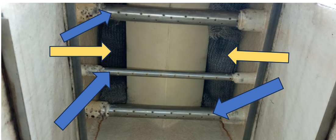
Figura 15: Borrifador de água e eliminador de gotas localizado na parte superior da torre
