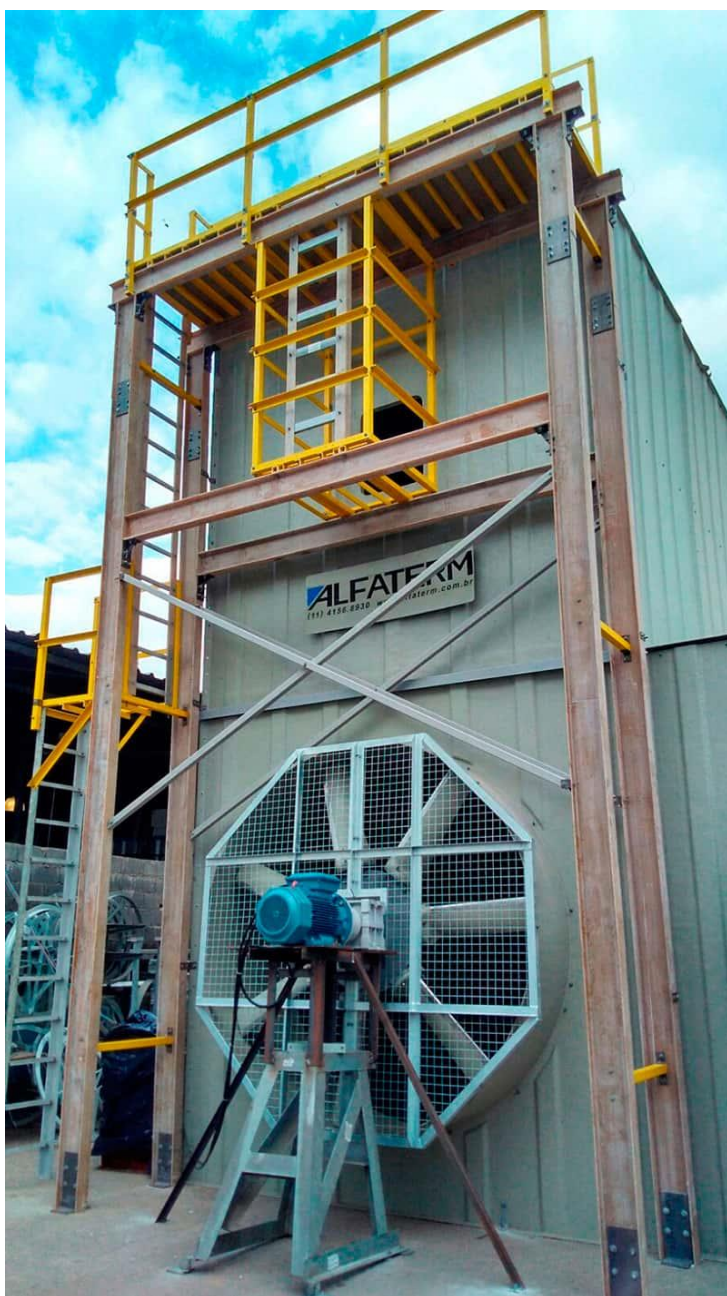
Figura 10: Ventilador de uma torre de resfriamento
