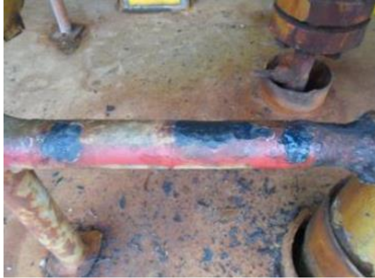
Figura 37 – Tubulação de transporte de gás de processo, componente com dano de perda de espessura localizada devido a corrosão externa. Fonte: Próprio autor.
