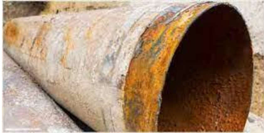
Figura 16 - Corrosão em tubo metálico. Fonte: ENCANADOR PORTO ALEGRE, 2023.
