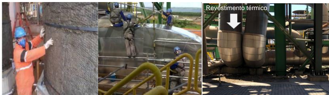
Figura 12 - Revestimentos Térmicos Aplicados em Tubulações Fonte: Autores
