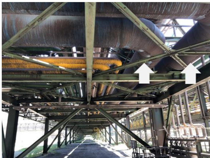
Figura 4 - Tubulações transportadoras de ar soprado
