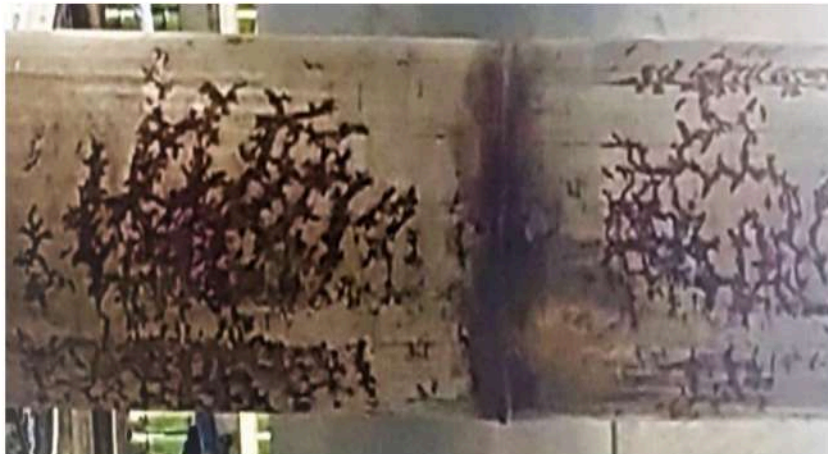
Figura 9 – Corrosão sob tensão detectada por ensaio visual. Fonte: OLIVEIRA, 2022
