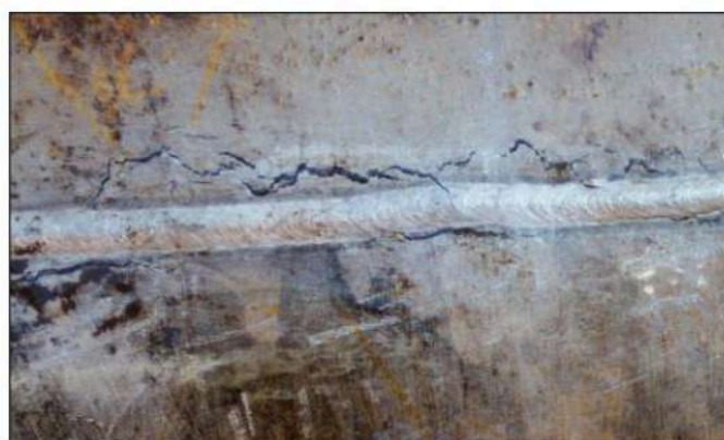
Figura 5 - Trincas de corrosão sob tensão em um vaso de pressão Fonte: SCHULZ, 2004
