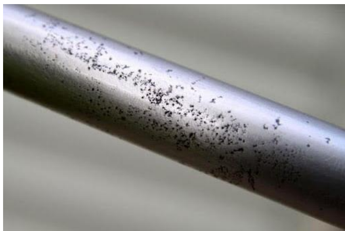
Figura 3– Corrosão por pite em Aço Carbono
