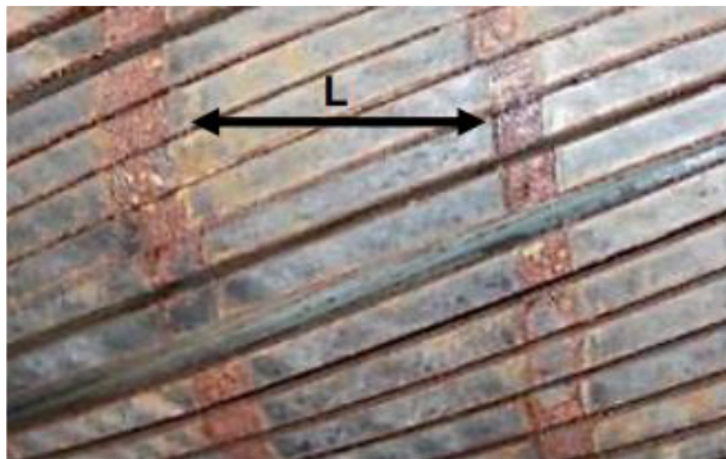
Figura 14: Corrosão nos arames de tração de riser alagado retirado de operação [10]
